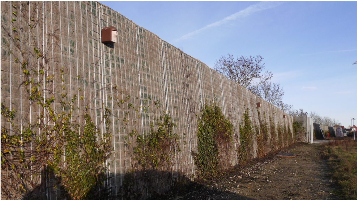
Nistkästen aus Holzbeton an der Lärmschutzwand in Heßdorf Süd
